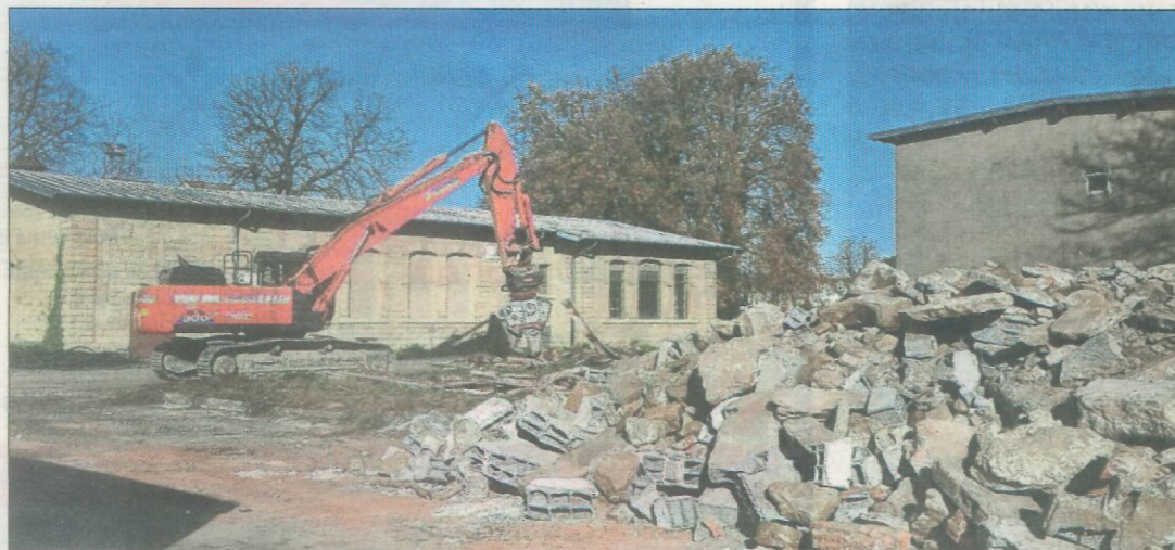
En novembre, la démolition de certains bâtiments du quartier Lizé à Montigny-lès-Metz. 2021 voit la suite du programme. Photo RL
