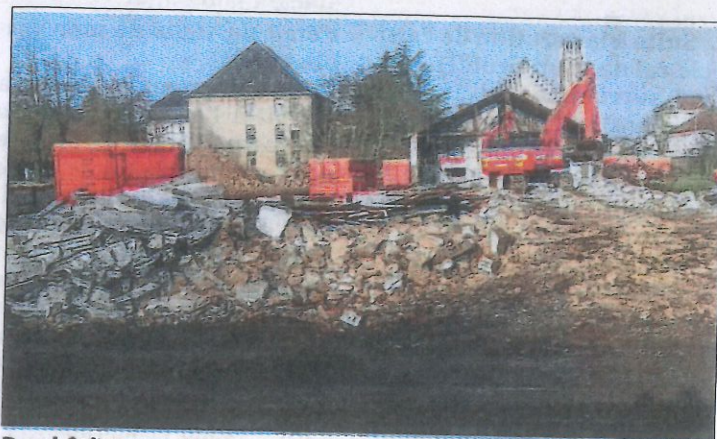
Des bâtiments, il ne reste que des tas de gravats. Photo RL
